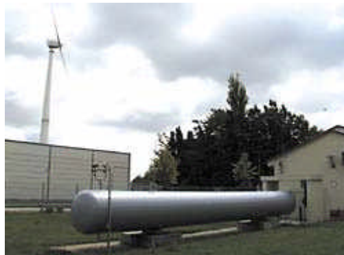
Elektrolytische Wasserstoffherzeugung aus Windkraft an der FH Stralsund
